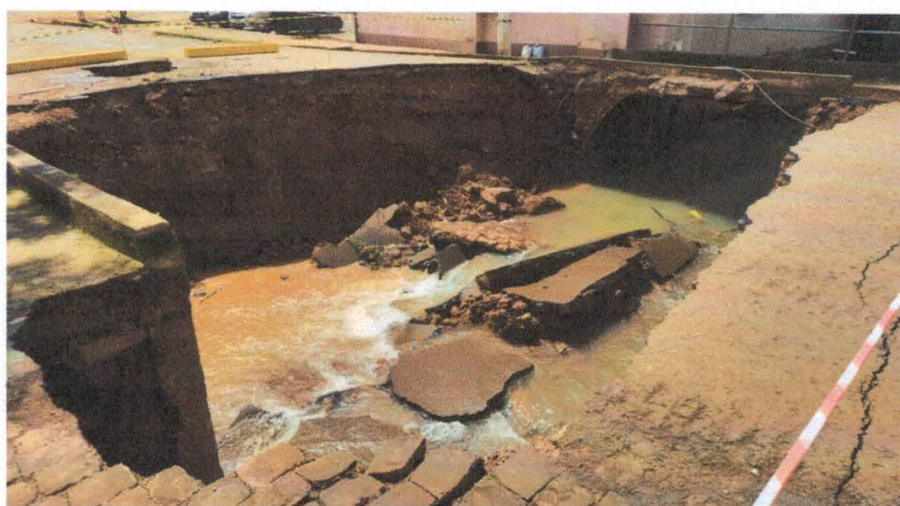
Ponte destruída sobre o Arroio Sananduva na Rua Ernesto Damas.
