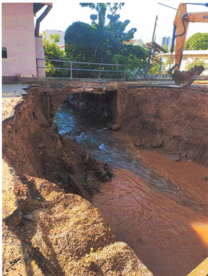
Ponte destruída sobre o Arroio Sananduva na Rua Ernesto Damas.
