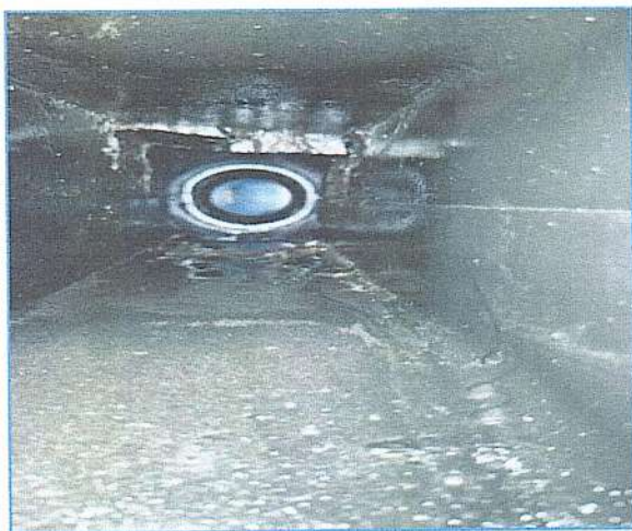
IMAGEM DA PARTE INTERNA DO DIFERENCIAL, SINAIS DE DEFORMAÇÃO E SOLDAS
